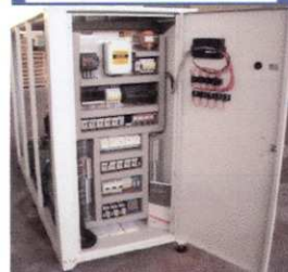
Centrale con gestione evaporatori con valvola elettronica
